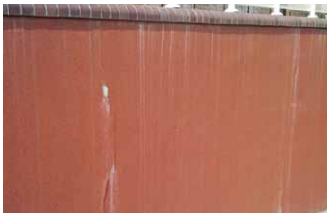
Zdjęcie 2 – Wykwity pod fugami pomiędzy kształtkami klinkierowymi.
