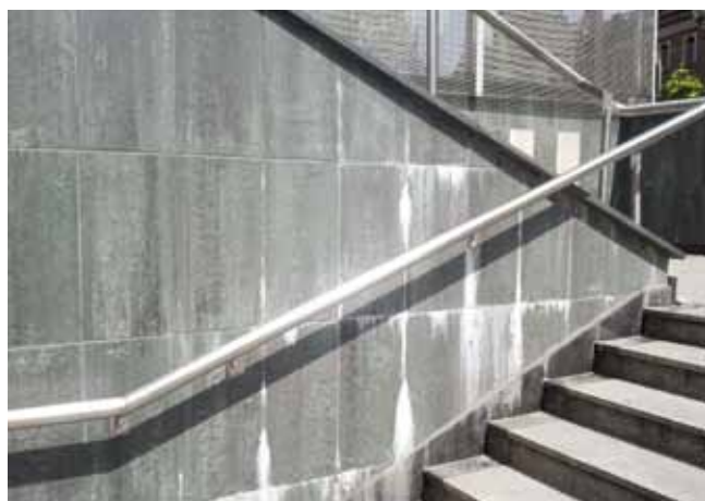
Zdjęcie 1 – Wykwity solne na ścianie
