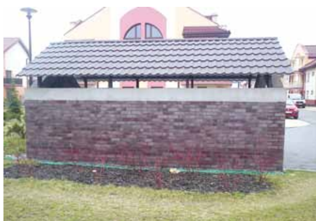
Zdjęcie 4 – Odpowiedni dobór kolorystyczny na murze tuszuje nieznaczne wykwyty
