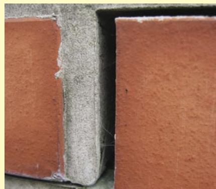
Zdjęcie 10. Nadmiar środka napowietrzającego w zaprawie może spowodować utratę jej przyczepności do podłoża.
