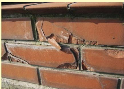
Zdjęcie 1. Super wytrzymała, sztywna zaprawa o słabej przyczepności do cegły może szybko uszkodzić mur. Zaprawa cementowa z plastyfikatorem.
