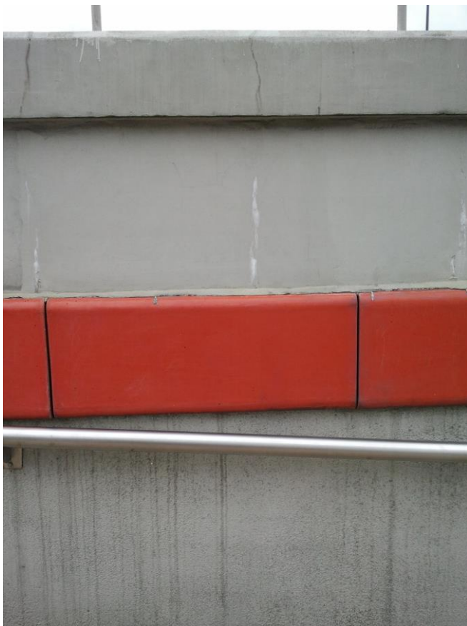
Fot. 1 Wykwity solne na elemencie betonowym.
