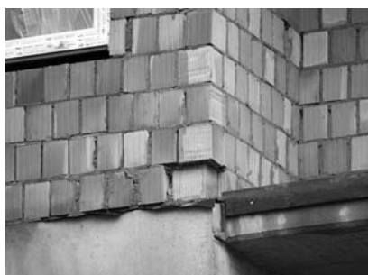
Fot. 1. Krzywo wymurowane ściany budynków to dziś standard na polskich budowach
