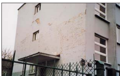
Zdjęcie 4. Przy odnawianiu elewacji wykonanej w tynkach cementowo-wapiennych zastosowano wyprawy tynkarskie nieprzepuszczalne dla pary wodnej.
