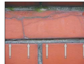
Zdjęcie 5. Mur po 4 latach eksploatacji. Widoczna jest utrata przyczepności zaprawy do podłoża oraz liczne pęknięcia cegły.
