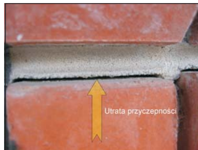
Zdjęcie 3. Zaprawa cementowa z domieszką napowietrzającą. Nastąpiła utrata przyczepności do podłoża.
